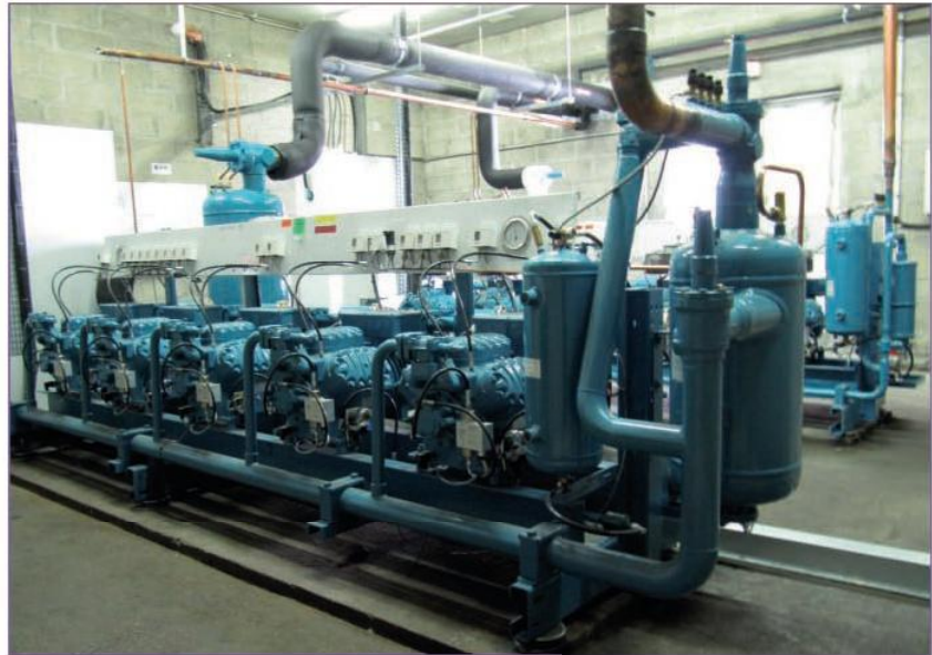
Installation frigorifique de l'établissement Le Delas.
