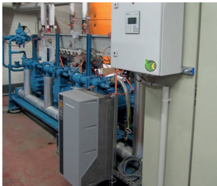
La consommation énergétique de référence lors de la détection était de 5 500 kWh/jour. Elle est aujourd'hui de 4 000 kWh/jour.
